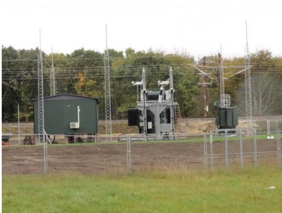
Figur 3-44 Eksempel på fordelingsstation ved Lykkegaard i Esbjerg langs banestrækningen Esbjerg–Lunderskov.
