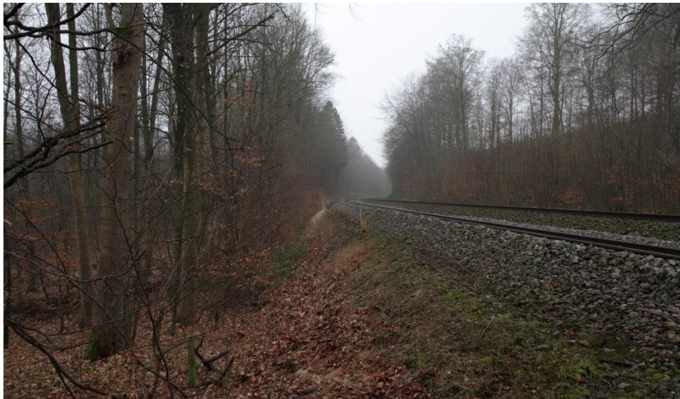
Figur 54: Fotoet er taget på jernbanen sydøstlige side. På denne strækning skrånner jernbanedæmningen ned mod skoven.
