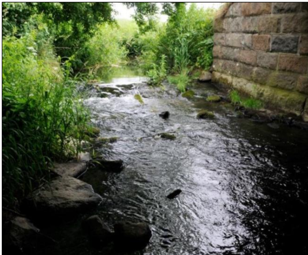
Figur 21. Spørring Å ved underføringen.
