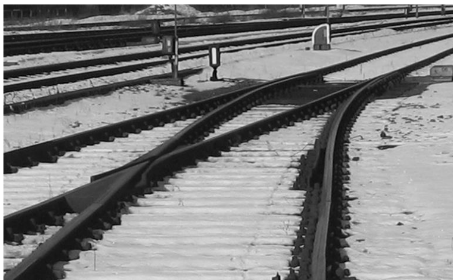
Figur 328 – Sidebeliggenhedsfejls umiddelbart før tvangsskinne
