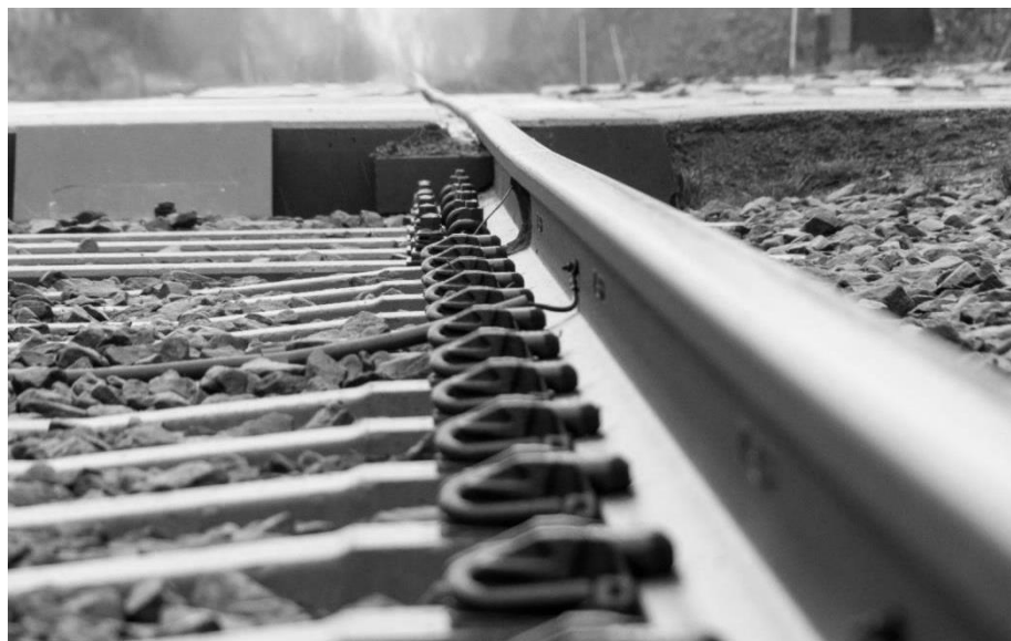
Figur 326 – Kortbølgede højdefejl i klasse 4 i overgangszonen mellem strækningsspor og overkørsel
