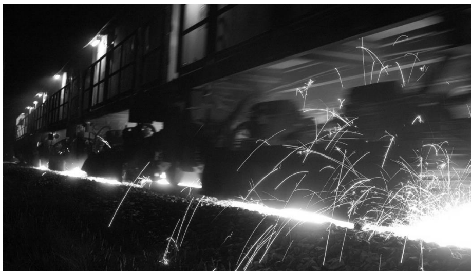
Figur 126 – Roterende slibetog i drift
