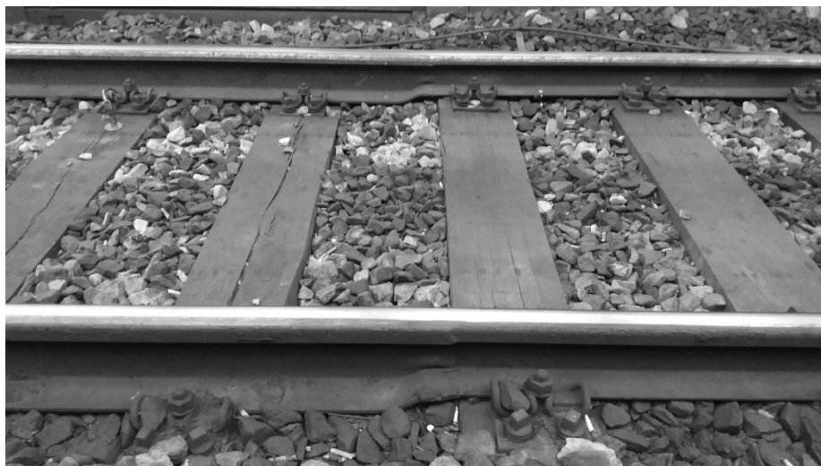
Figur 118 – Overgangsskinne mellem 60E2-45E2 på Københavns Hovedbanegård i forbindelse med perrontunnel
