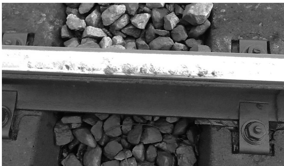
Figur 111 – Kørekantsrevner (head checks) med afskalning
