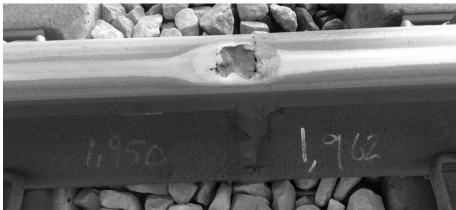
Figur 108 – Lodret tværgående revne i thermitsvejsning
