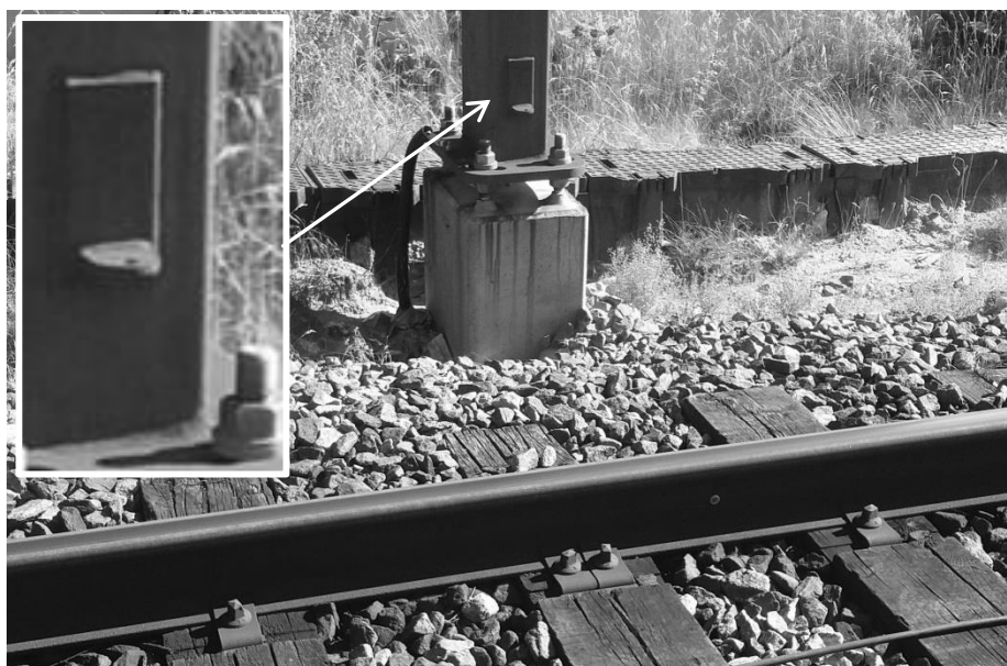
Figur 317 – Referencemærke placeret på køreledningsmast
