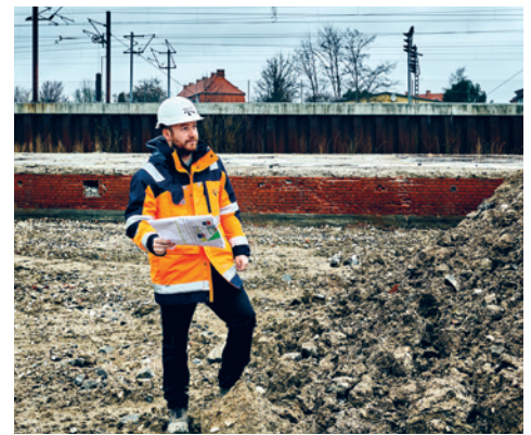
I SPORET. "Gevinsten er, at vi undgår unødigt ventetid og komplikationer ved krydsninger mellem den eksisterende Øresundsbane og den nye bane mellem København og Ringsted, fortæller byggeleder Christian Adler Svanholm. Foto: Jesper Blæsild
