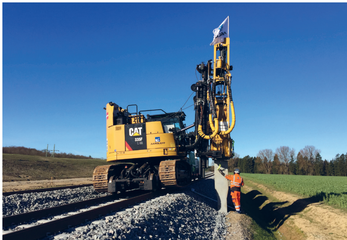
I GANG. Her bliver det første kørestrømsfundament sat ved Kongsted i Ringsted Kommune. Det tager et kvarter at ramme pælen ned i jorden. Foto: Aarsleff Rail
