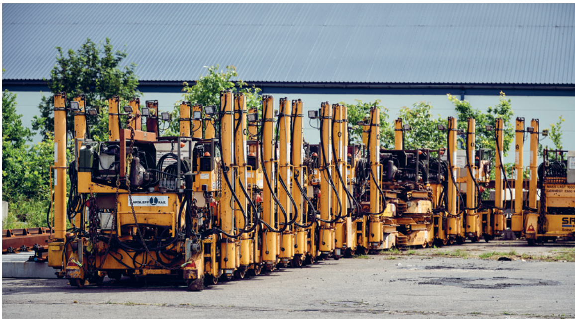
KLAR I KOKKEDAL. Opdelingen af sporfornyelsen fra én lang spærring til to kortere spærringer, betyder, at spærringerne kan holdes i sommerferieperioden, hvor der traditionelt set er færre passagerer, der bruger toget. I Kokkedal er maskiner og sporrammer klar. Foto: Jesper Blæsild
