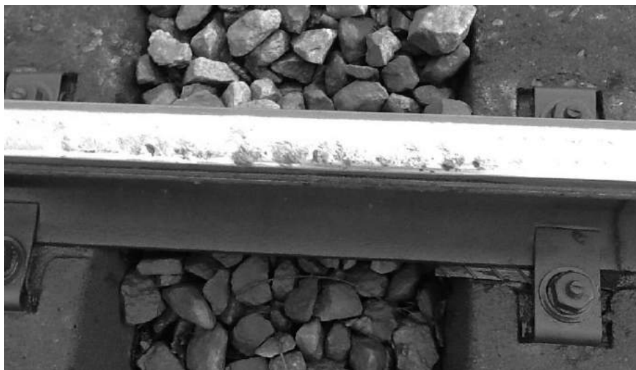
Figur 111 – Kørekantsrevner (head checks) med afskalning
