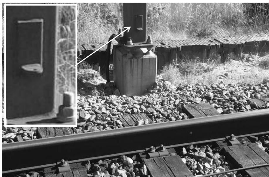
Figur 317 – Referencemærke placeret på køreledningsmast
