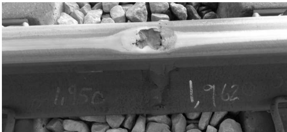
Figur 108 – Lodret tværgående revne i thermitsvejsning
