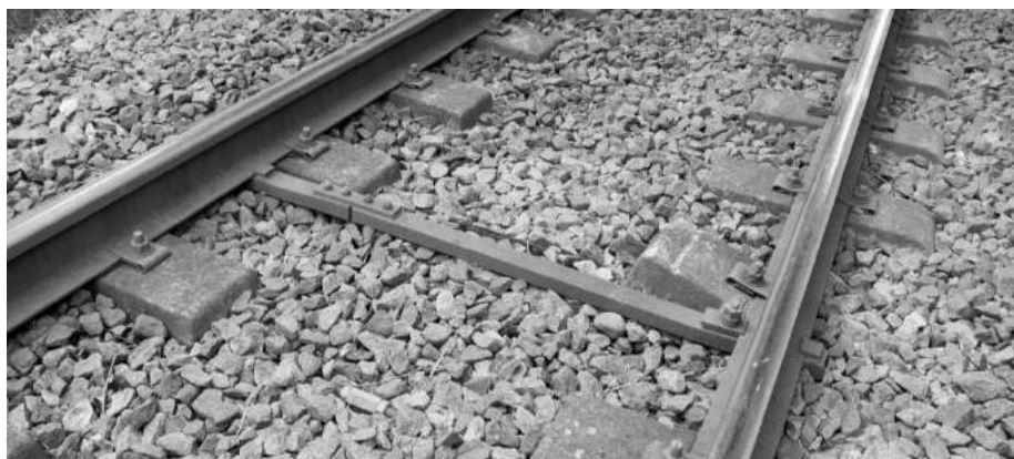
Figur 115 – Afstandsjern ved knækket to-bloksveller
