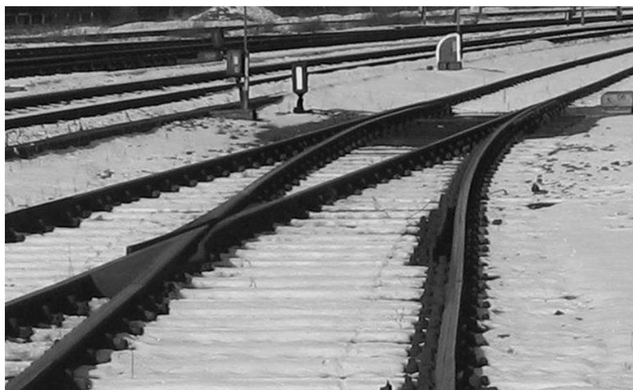
Figur 328 – Sidebeliggenhedsfejl umiddelbart før tvangsskinne
