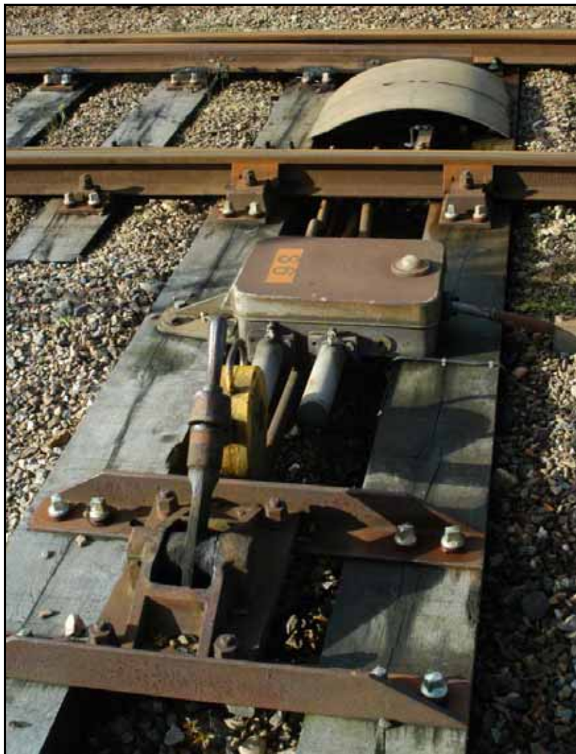
Centralaflåst sporskifte med magnetlås
