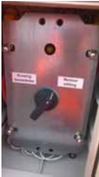
Stedlig dækning udkoblet:
